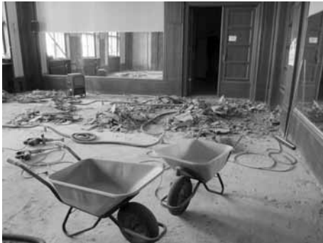
Wasserschaden im kleinen Trainingsaal
